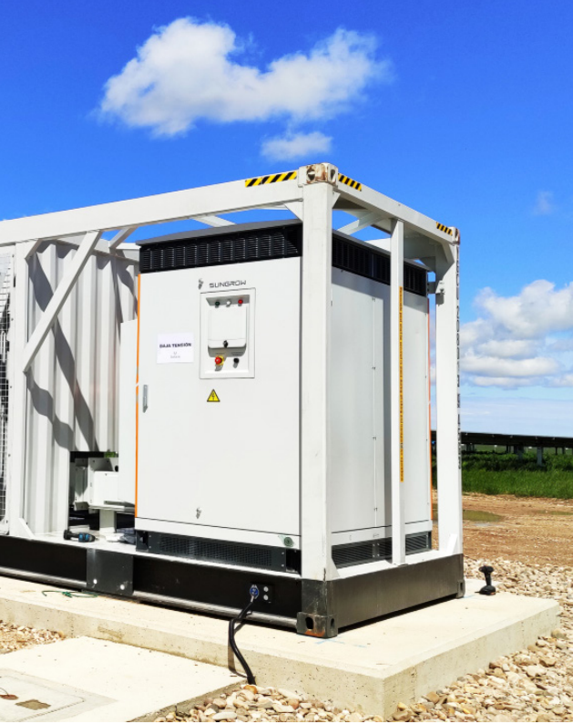
SG6250HV-MV ile 24 MW PV sahası in Palencia, İspanya
